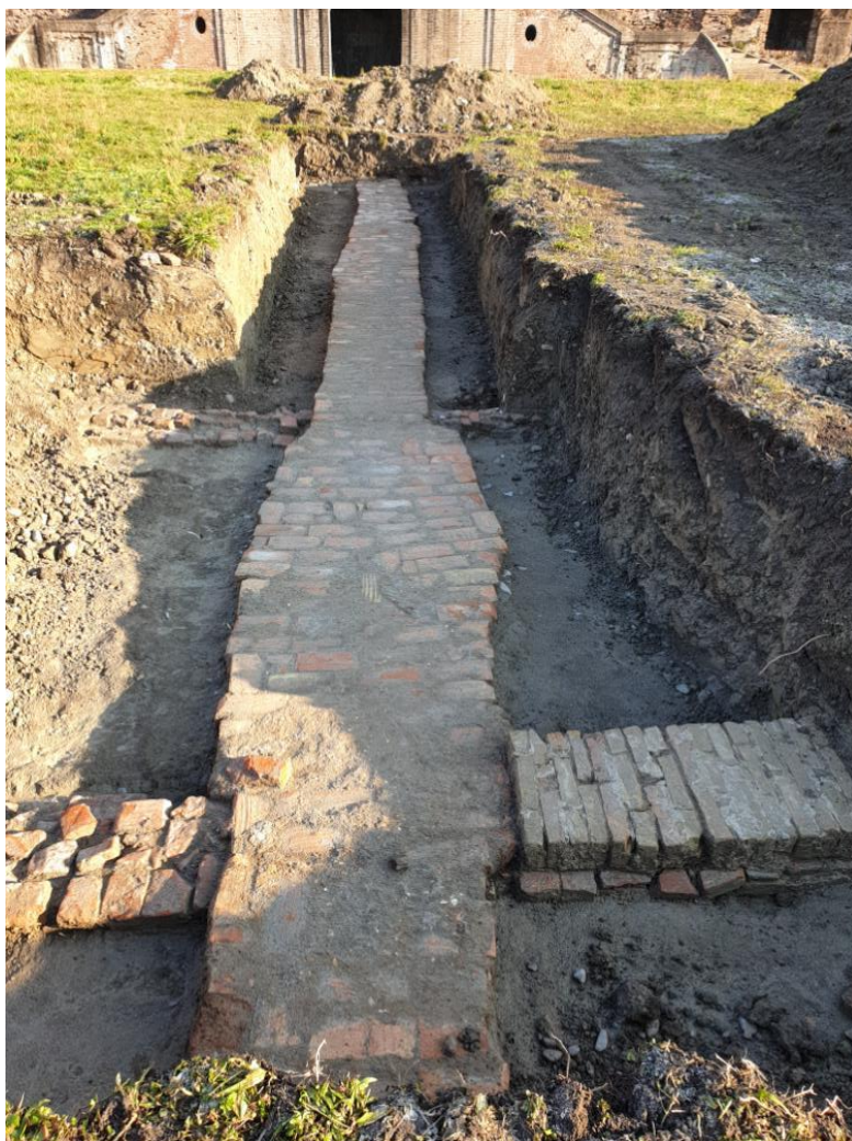
Fig. 14 Parterre - Condotta idrica di adduzione alla vasca centrale nel punto in cui intercetta il vecchio corso del Canale di Sassuolo, vista dalla fontana
